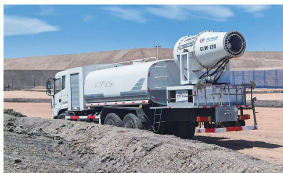
防風降塵網及噴淋設備
